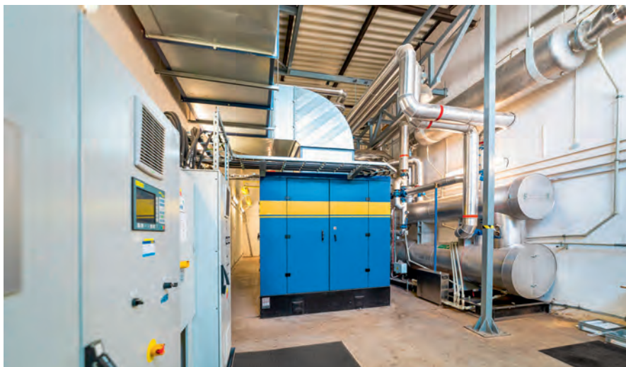
V minulosti byly pořízeny do dvou kotelen Městského bytového podniku kogenerační jednotky. Foto Radek Štěpán
